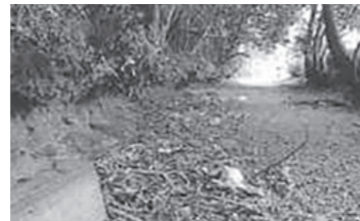
釜ヶ淵用水路の隧道下流水路の改修が待たれる様子
