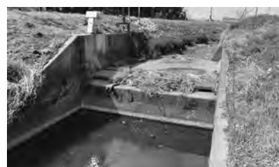
占有物の河口せきなどは、鬼怒川東部土地改良区(設置者)が管理
