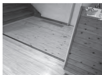
目に見えない湿気で床が腐食し修理(西小)
