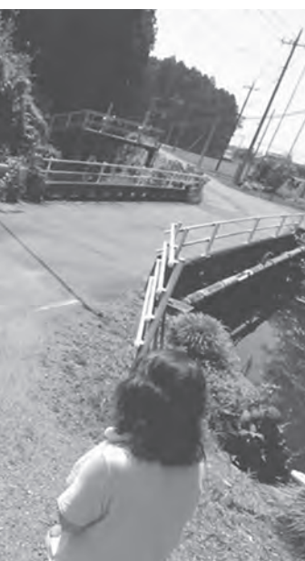
に接触する危険がある (平田地内の冷子川に架かる橋)
