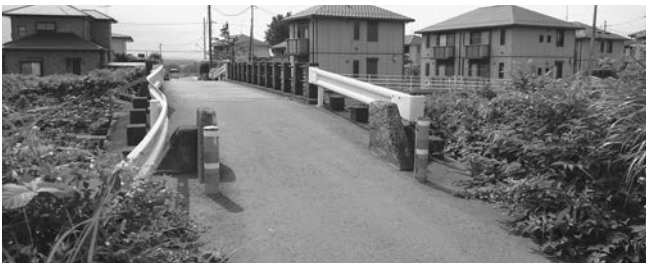
拡幅した架け替えが望まれる町道119号線跨線橋
