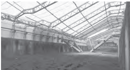
突風で被害を受けた土づくりセンターの屋根
