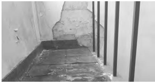
壁や床の破損状態
