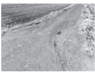
路肩が崩れ危険な農道 早期修繕を
