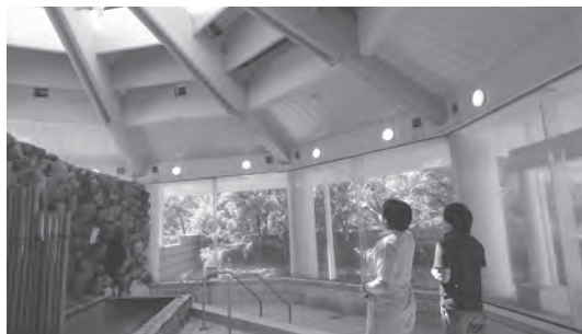
浴室の現状を確認（汚れ・腐食が見られた）
