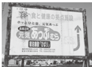
鉄部が腐食した看板 危険要因は無くすべき
